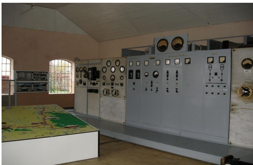
Foto 247. Panoul de comandă a substației de redresare Ghioroc. Conține aparatură electrică și conecțică la 1500 Vcc originală, produsă între anii 1913-1926, de către firme de renume: Siemens, Ganz, Brown-Boveri.
